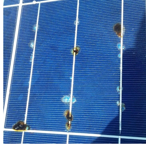
Hot Spot Kaynaklı Bozulma
