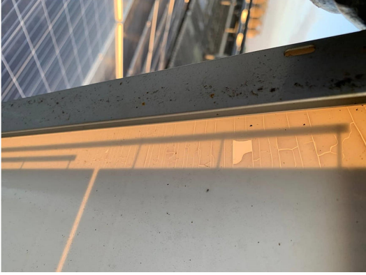
Çatlamış bir arka tabaka su izolasyonu sağlayamaz
